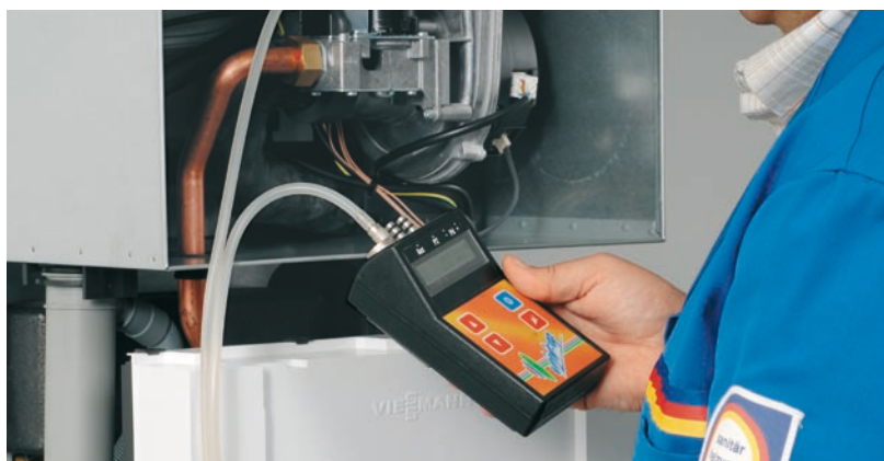
专业和适时地维护保养保证了供热系统的无障碍运行
